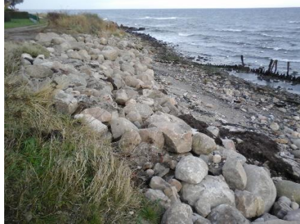
Ausgebesserte Küstenstrecke in Dahmeshöved (Foto: Jürgen Möller)
